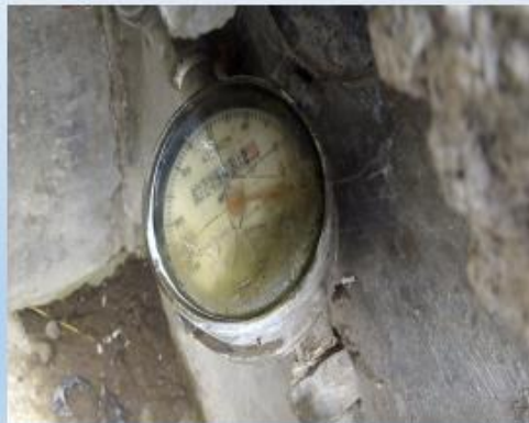
CONTROL DE MEDIDORES
