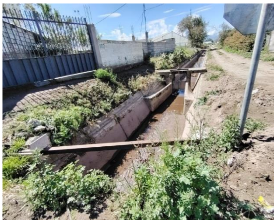
Canal de Riego Sistema Latacunga Salcedo Ambato
